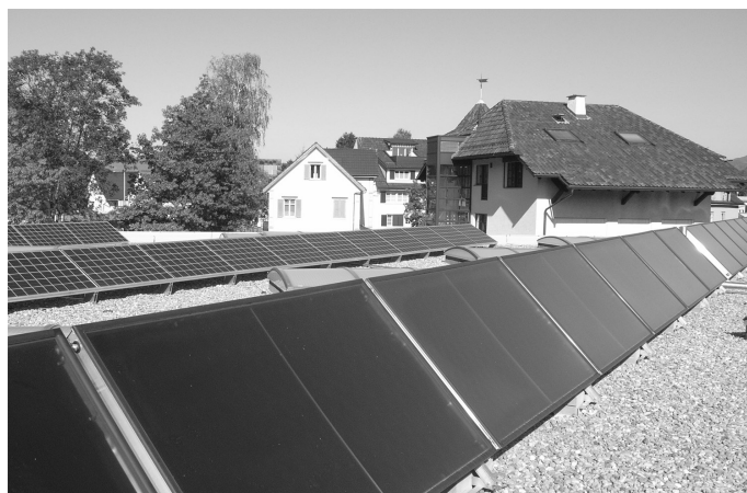
Wärmeversorgung über Solarthermie in Kombination mit Erdwärme
