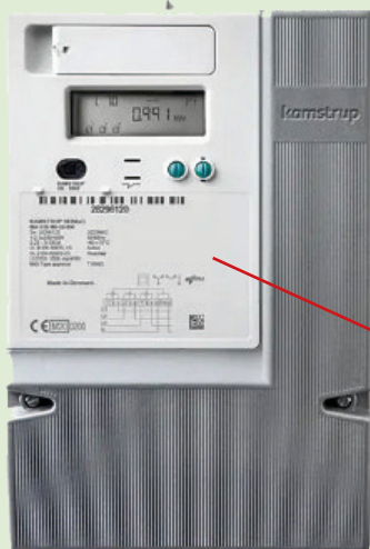
Elektro- und Wasserzähler Kamstrup 382M
