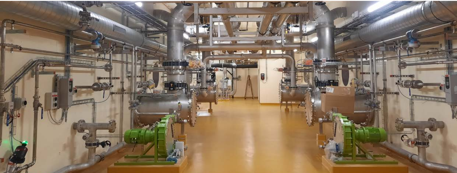
Zweckverband Abwasserwerk Rosenbergsau: Ein Teil der Rohrleitungen und Aggregate der neuen EMV-Anlage
